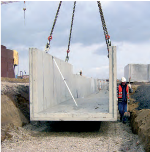
Kanal do umiejscowienia mediów wg WHG
