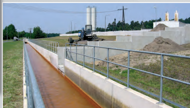
Instalacja oczyszczająca wodę kopalnianą
