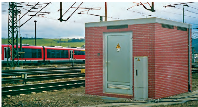
Stacja podgrzewająca zwrotnice
