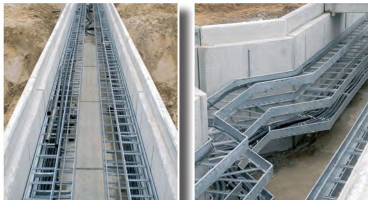
Kanały do umiejscowienia mediów z półkami kablowymi
