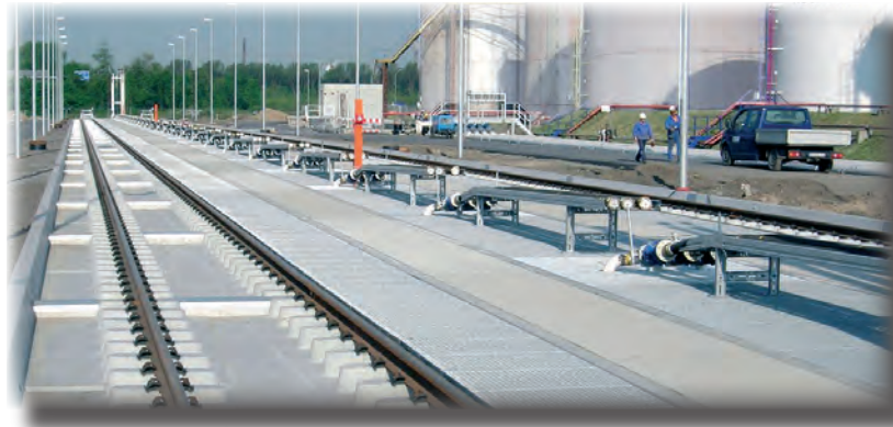
Stacja wyladowcza dla wagonów zbiornikowych (system)
